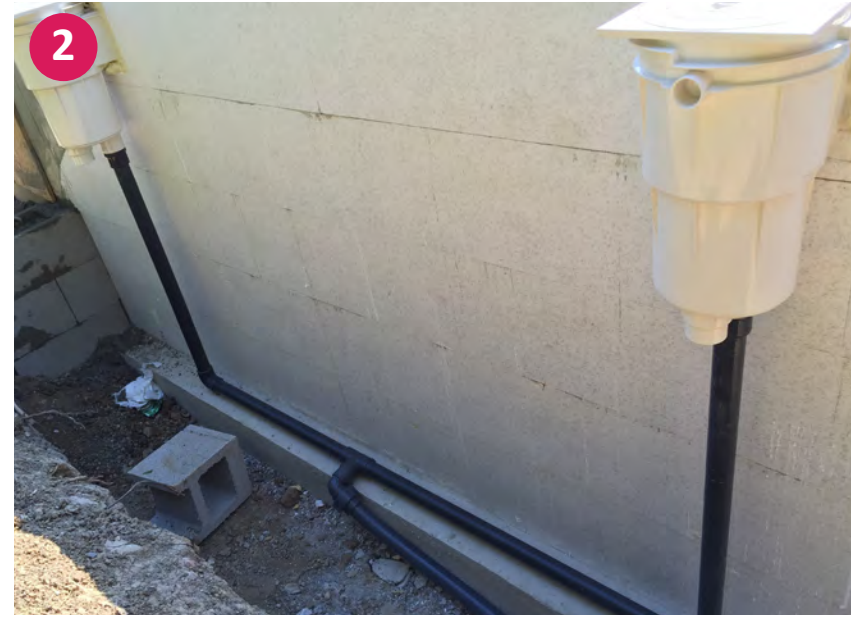
▲ Verrohrung von 2 Skimmer
